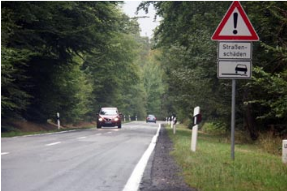
Beschilderung eines Mangels: Die Straße von Eulbach zum Hainhaus bleibt sanierungsbedürftig.
